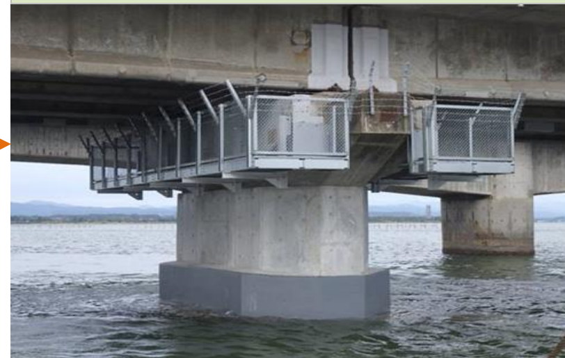
写真: ZEXEED製検査路(モニター施工)
