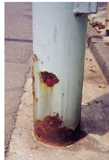
▲ 地際部 犬の尿により錆びた状態
