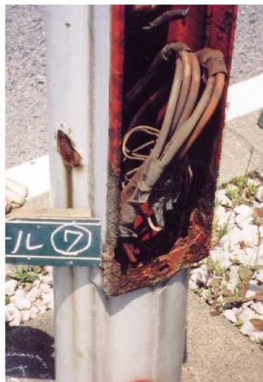
▲ 開口蓋を外した状態
