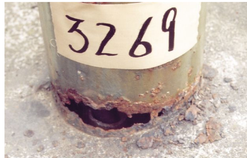
▲ 地際部が錆び、孔が開いた状態
