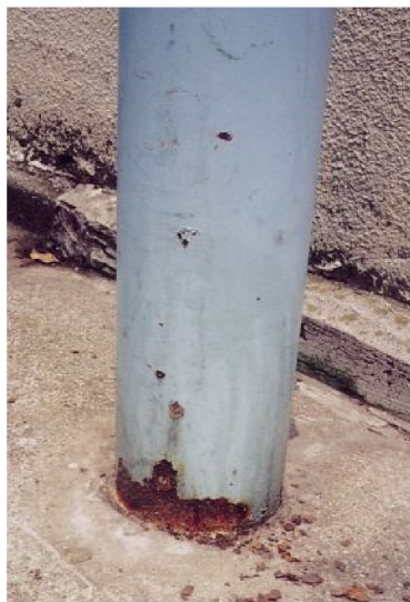
▲ 地際部 犬の尿により錆びた状態
