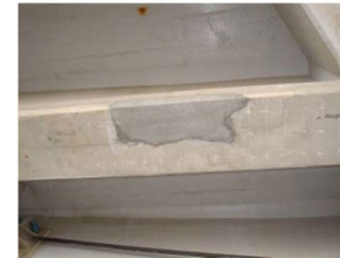
a) 断面修復材の剥落前
