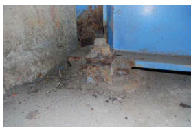
損傷写真（近景）
