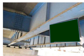
損傷写真（全景、黒板入り）
