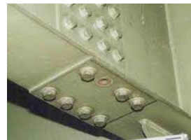
ボルトのゆるみ・脱落
