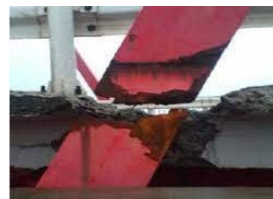
トラス橋斜材の破断
