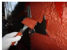
塗膜剥離状況
