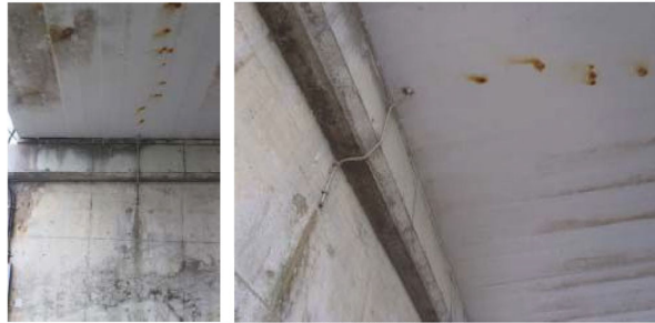
写真 9-1 線状に並んだ錆汁の発生状況
