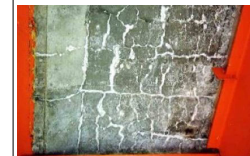
床版ひびわれ
