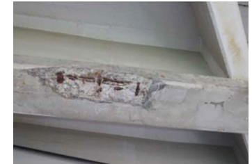
b) 断面修復材の剥落後
