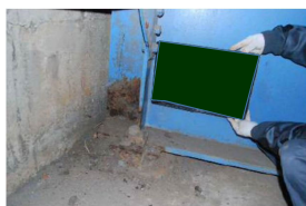
損傷写真（全景、黒板入り）
