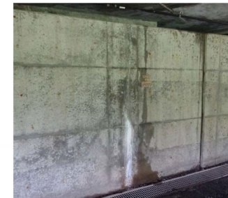
写真 23-1 ひび割れ注入後に短期間で析出したエフロレッセンスと漏水
