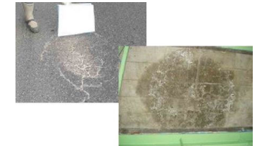
舗装の変状と床版下面の状況
