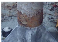
Ⅲ: 早期措置段階 損傷度 c、ii
