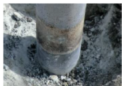
Ⅱ: 予防保全段階 損傷度 c、i
